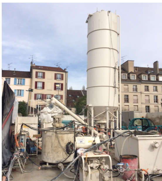
la centrale à béton
